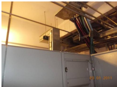
Figura 1.31 – saída do barramento blindado do painel de baixa tensão localizado próximo à subestação
