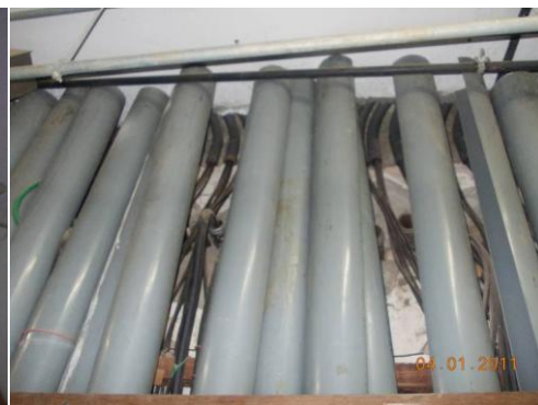
Figura 1.17 – cabos de cobre utilizados na interligação entre os painéis de baixa tensão e os quadros de distribuição
