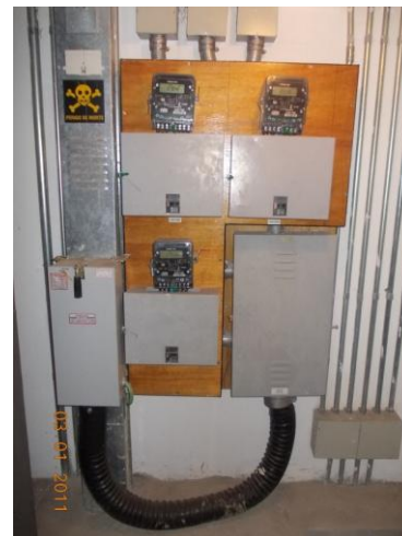
Figura 1.32 – conexão do barramento blindado aos medidores de energia elétrica
