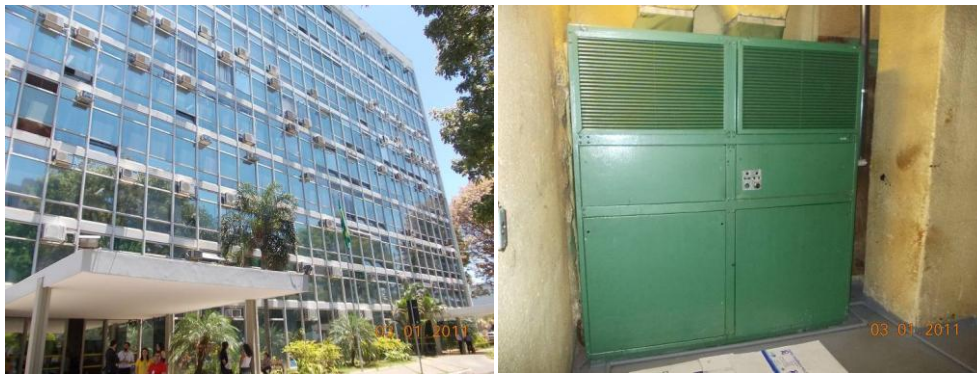
Figura 1.7 – equipamentos do sistema de climatização
