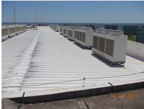
Figura 1.14 – equipamentos do sistema de climatização instalados na cobertura
