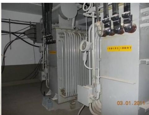
Figura 1.6 – equipamentos no interior da subestação
