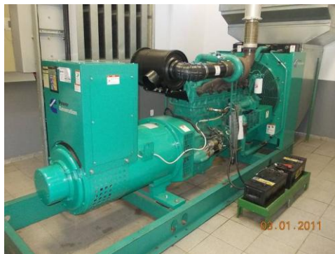
Figura 1.8 – grupo motor gerador
