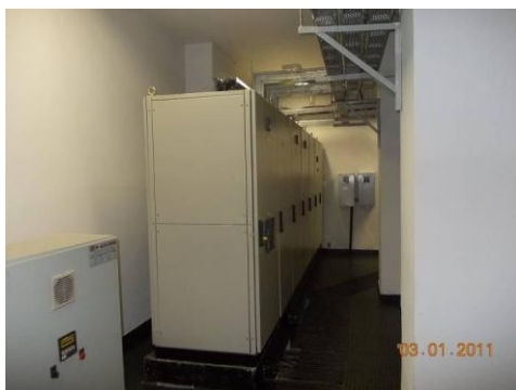
Figura 1.10 – painéis de baixa tensão, barramento blindado, banco de capacitores e o medidor, instalados próximos a subestação
