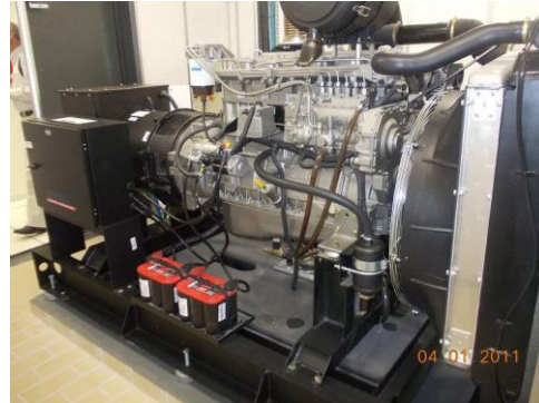
Figura 1.15 – grupo motor gerador
